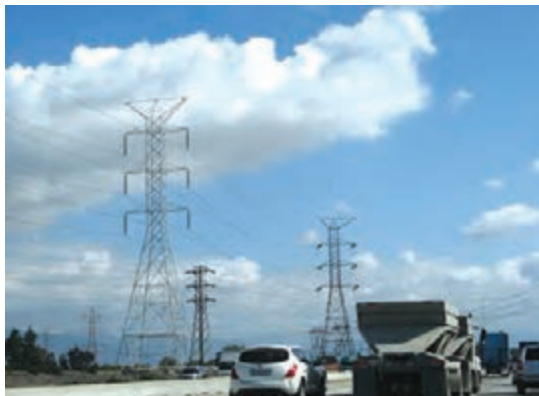
شکل ۵-۳- انتقال انرژی الکتریکی توسط دکل ها
